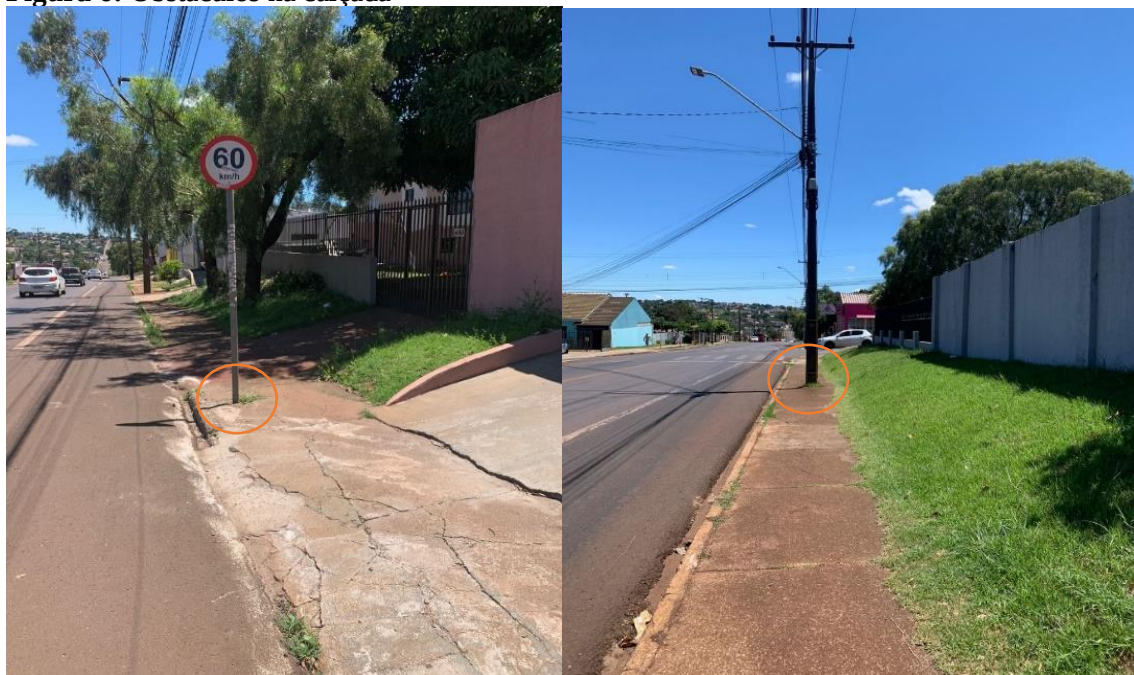
Figura 6: Obstáculos na calçada
