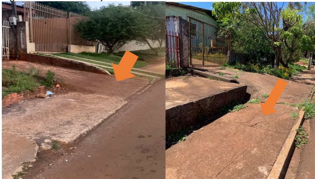
Figura 7: Desnível das calçadas
