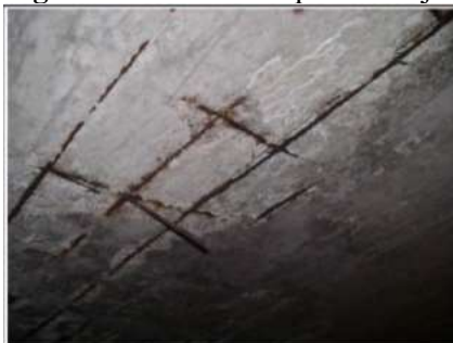
Figura 9: Armadura exposta na laje
