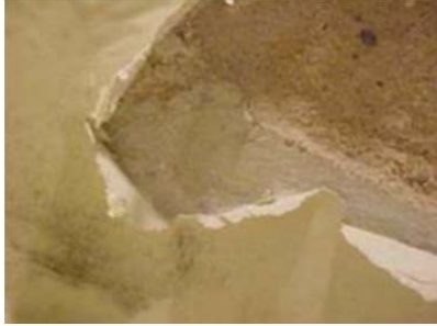
Figura 8: Desagregação de pintura
