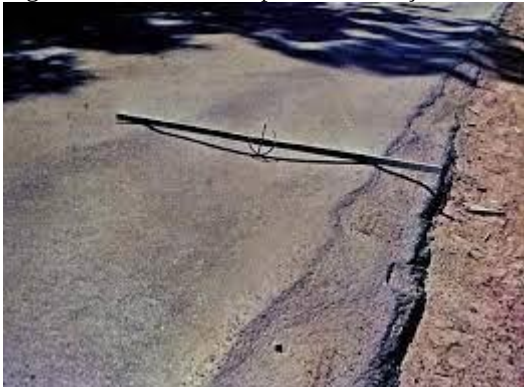
Figura 1: Afundamento por consolidação da trilha de roda (ATC)
