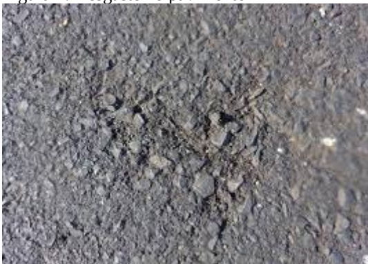
Figura 2: Desgaste no pavimento
