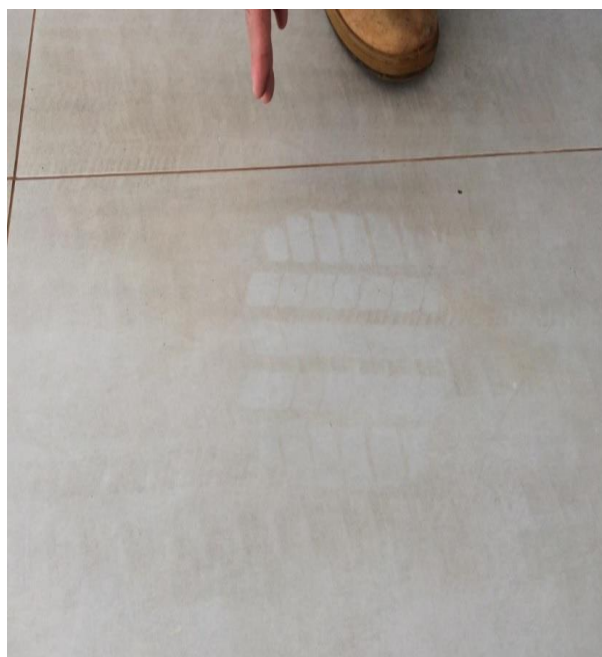
Figura 2 – Produto com manchas características de ataque químico.
