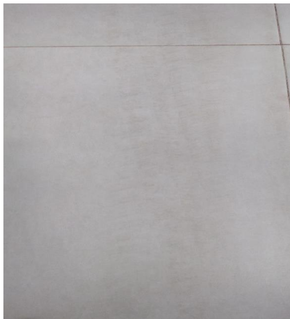
Figura 3 – Produto com manchas características de ataque químico.
