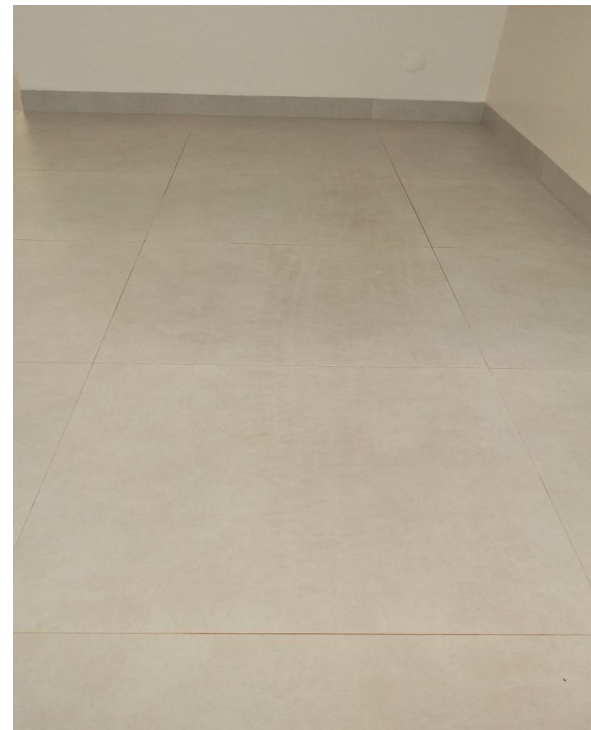
Figura 4 – Produto com manchas características de ataque químico.
