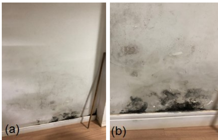
Figura 17 - Mofo na parede devido a infiltração.
