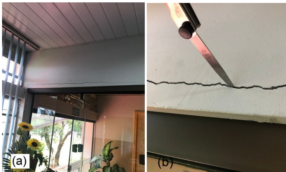
Figura 14 - Trinca na edificação.
