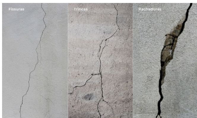
Figura 2 - Fissura, trinca e rachadura
