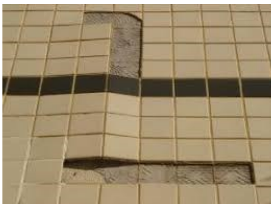
Figura 3 - Deslocamento revestimento cerâmico
