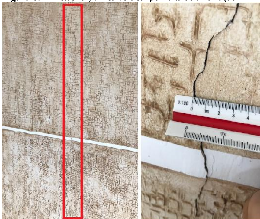
Figura 6: Trinca/pilar, trinca vertical por falta de amarração
