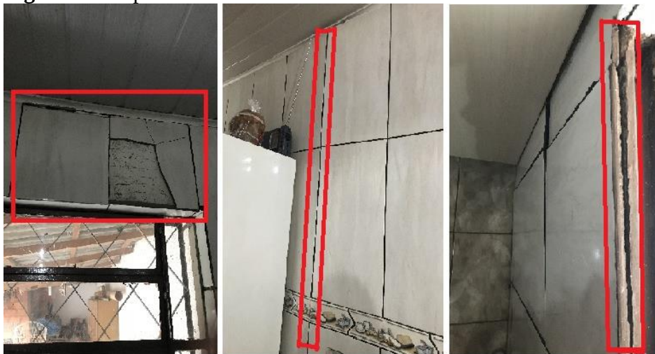
Figura 4: Deslocamento de revestimento
