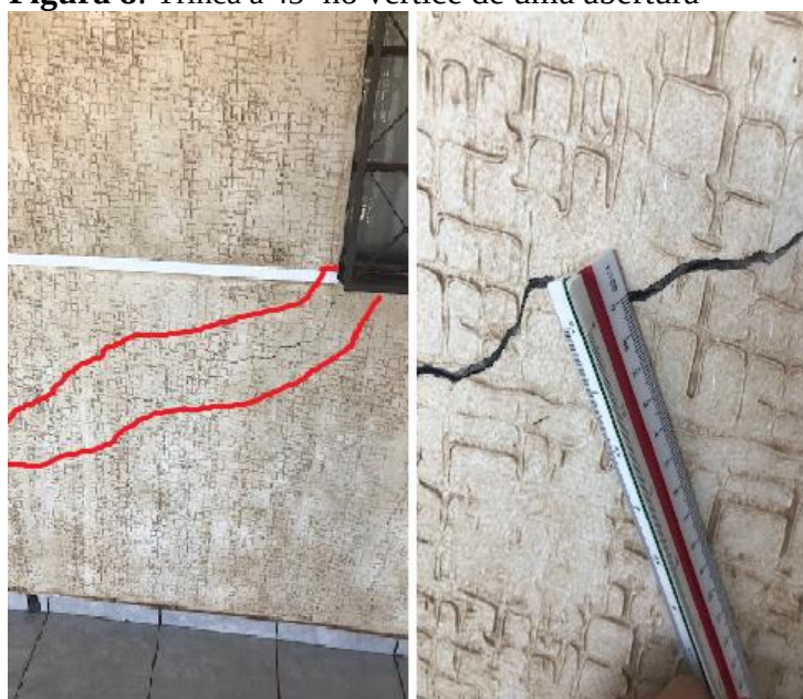
Figura 8: Trinca a 45° no vértice de uma abertura
