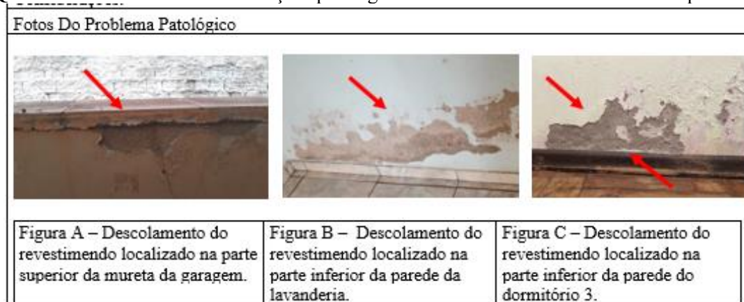
Quadro 11: Análise das manifestações patológicas – Descolamento do revestimento por empolamento.
