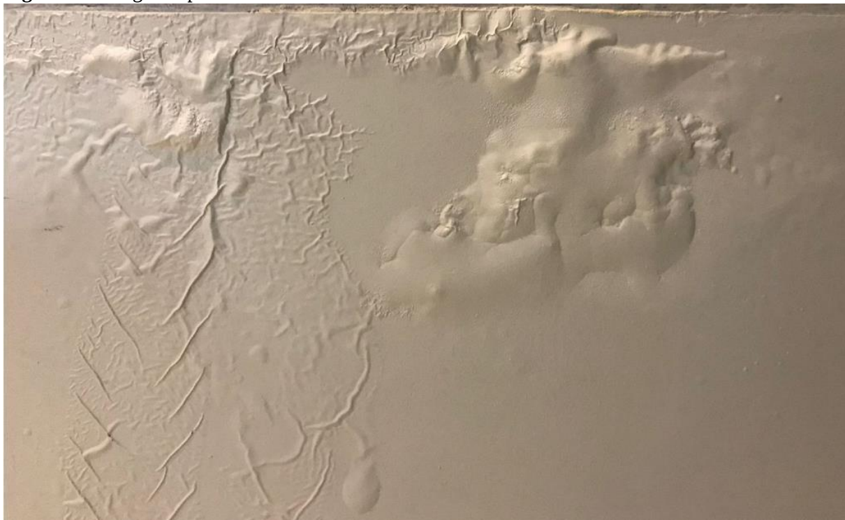
Figura 16: Fungo em parede no ambiente 8.
