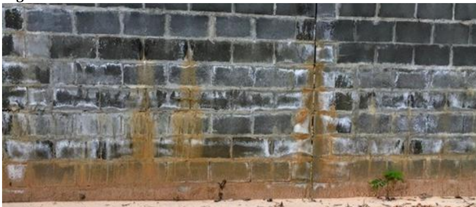
Figura 2: Eflorescência em bloco de concreto.
