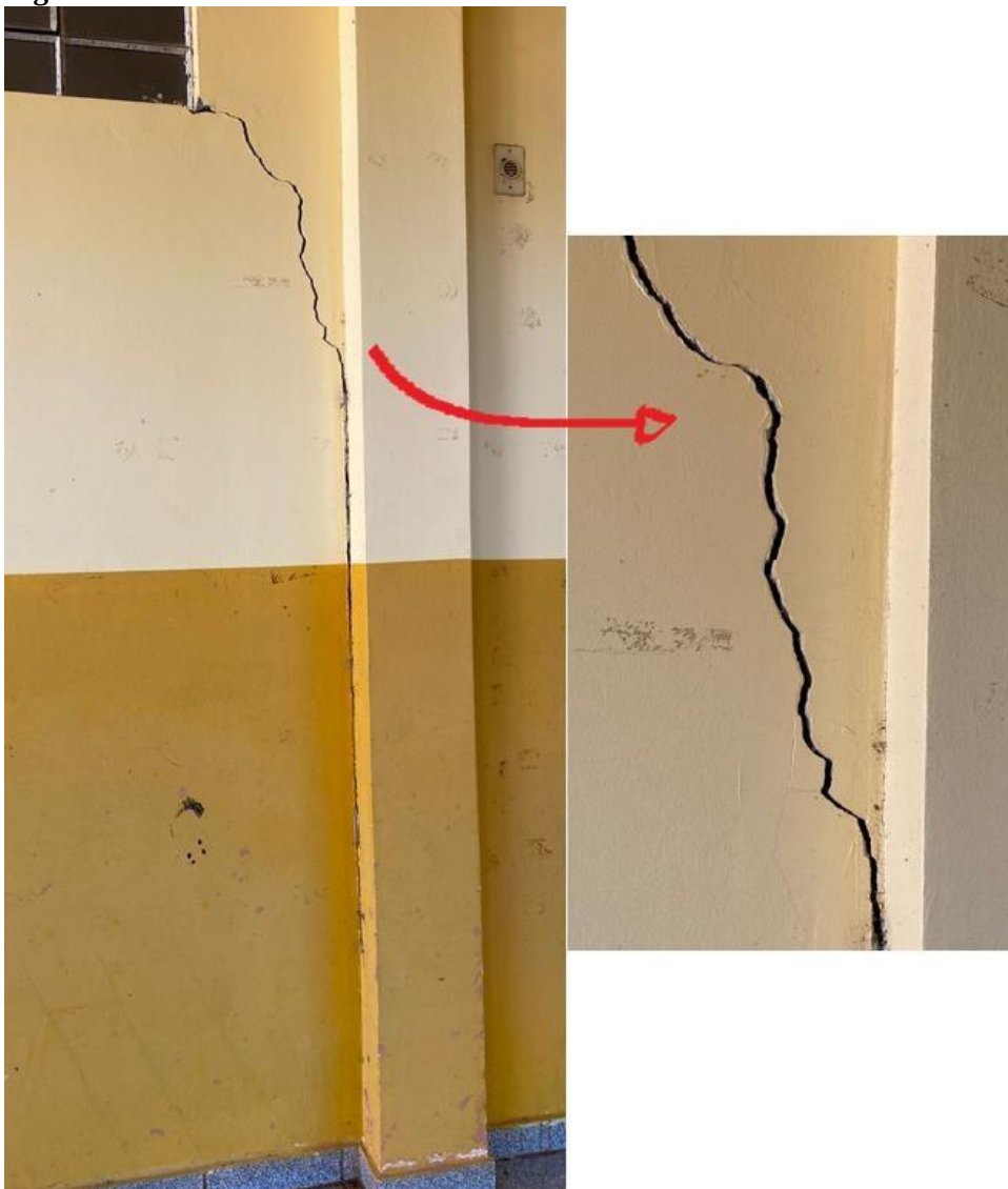
Figura 8: Trinca no ambiente 5.
