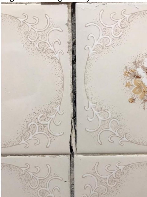
Figura 13: Fungo no rejunte no ambiente 2.
