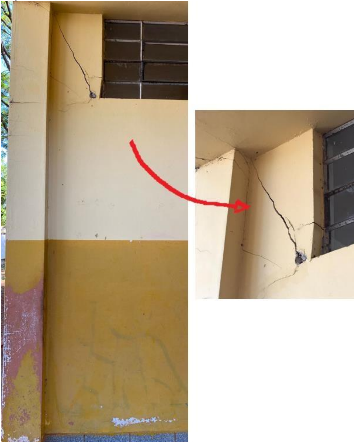
Figura 7: Trinca no ambiente 4.
