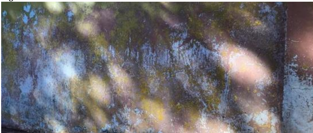
Figura 14: Descolamento de tinta no ambiente 7.
