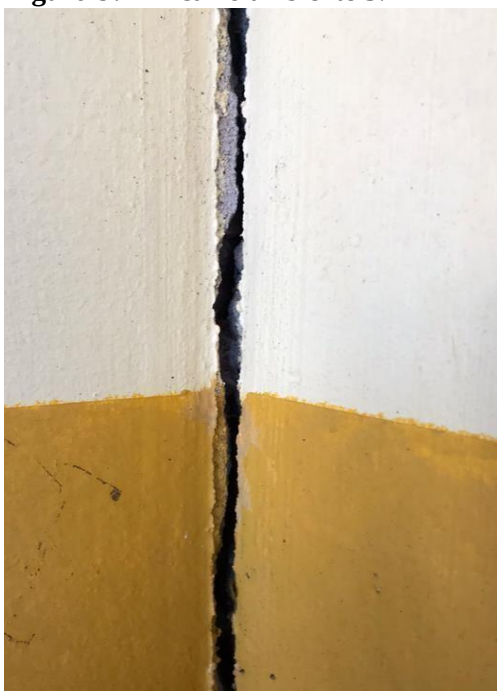
Figura 9: Trinca no ambiente 5.
