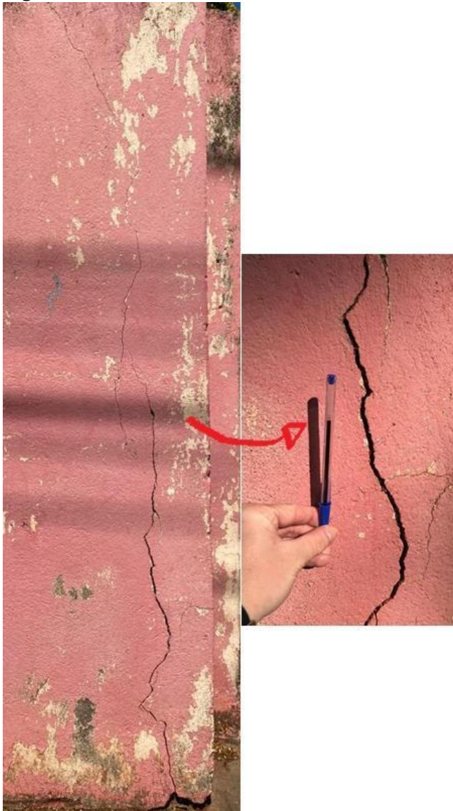
Figura 10: Trinca no ambiente 1.
