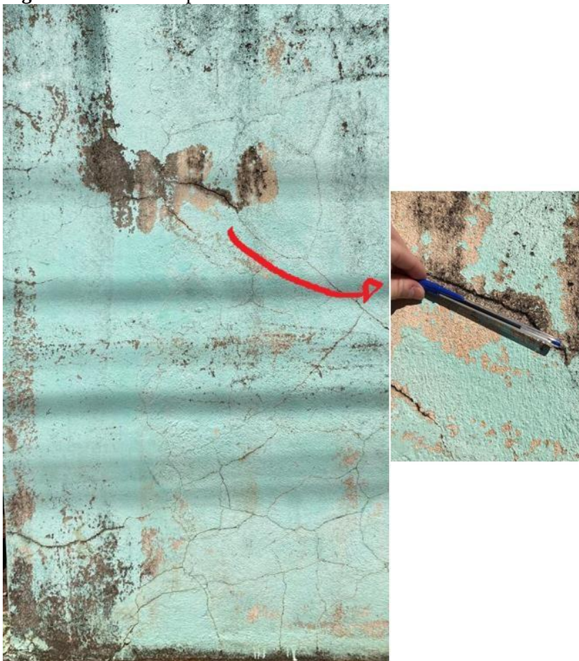
Figura 11: Fissura mapeada no ambiente 3.
