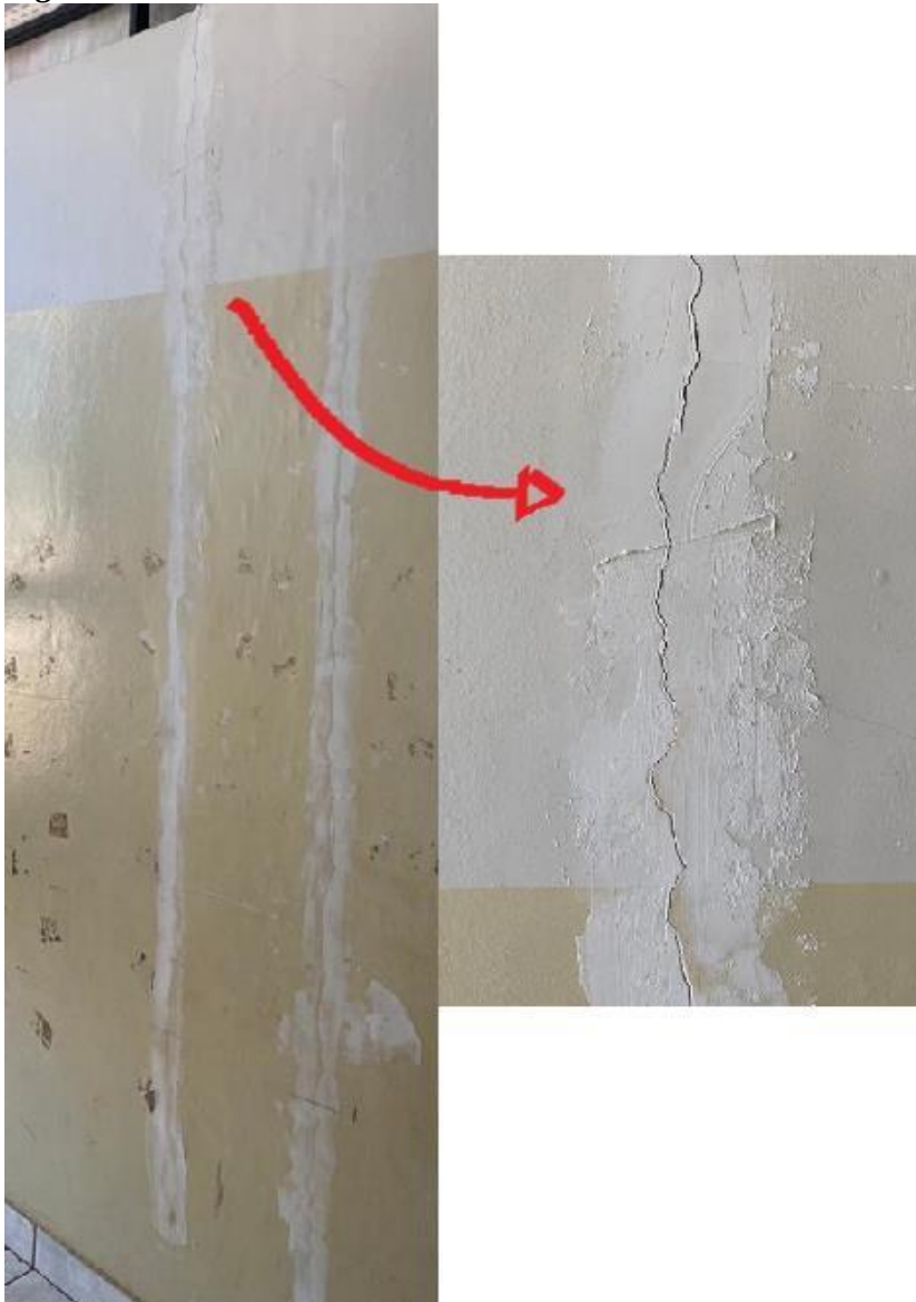
Figura 12: Fissura no ambiente 8.
