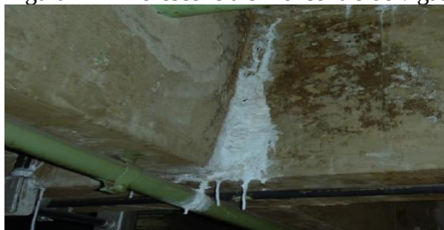
Figura 2 - Eflorescência em encontro de vigas em pavimento de garagem
