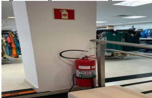
Figura 12: Agente extintor irregular
