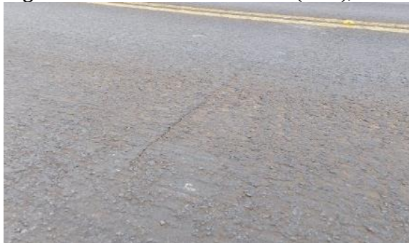
Figura 6: Trinca transversal curta (TTC), trecho do quilômetro 587.
