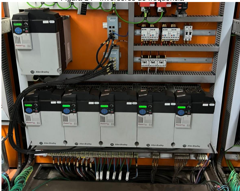
Figura 14 - Inversores de frequência
