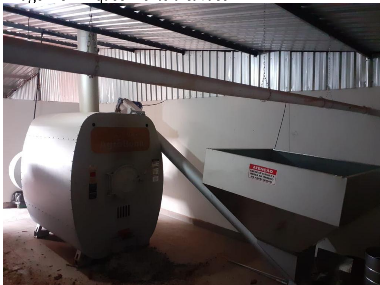
Imagem 8 – Aquecimento a cavaco
