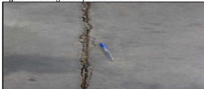
Figura 4: Patologia do tipo esborcinamento.
