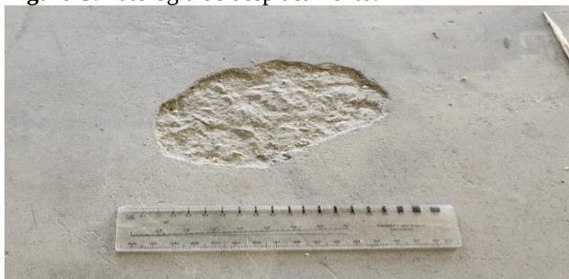
Figura 3: Patologia de deslocamento.
