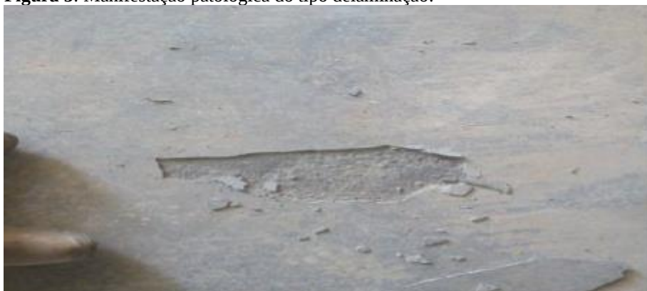
Figura 5: Manifestação patológica do tipo delaminação.
