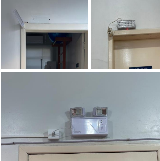
Figura 3: Luminárias de emergência em portas internas
