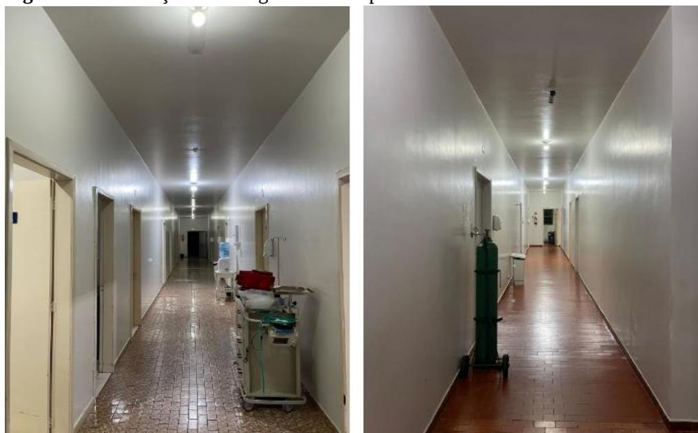
Figura 6 - Sinalização de emergência do hospital
