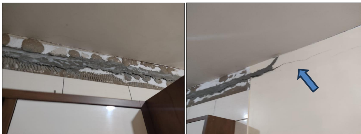
Figura 13 - Deslocamento de revestimento.
