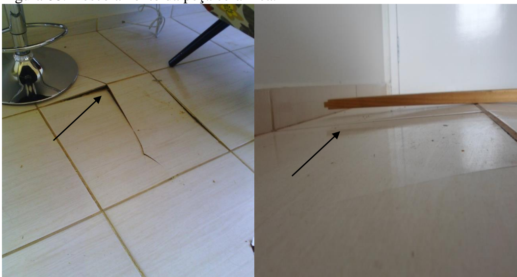
Figura 08: Descolamento da peça cerâmica.
