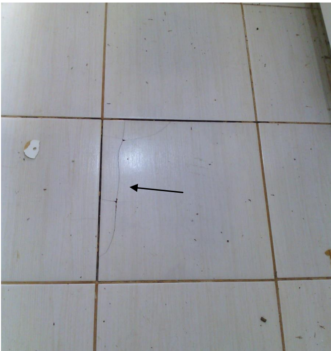
Figura 09: Fissura na peça cerâmica.
