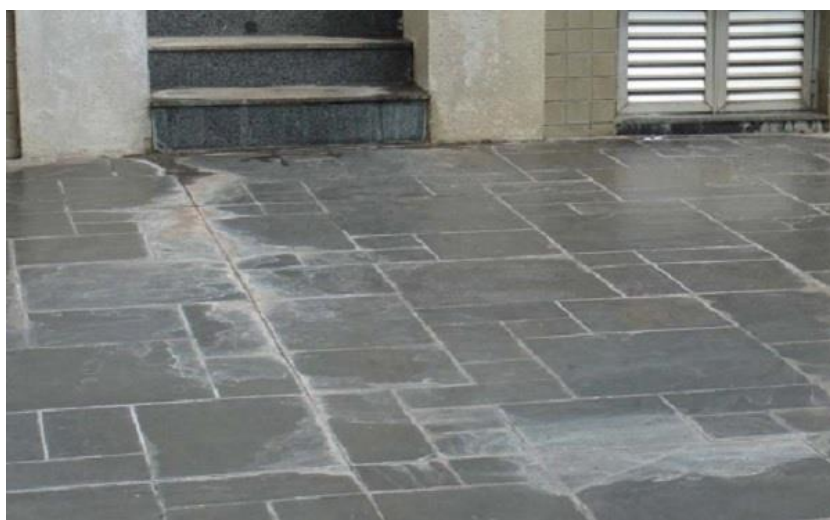
Figura 02: Eflorescência em cerâmicas.
