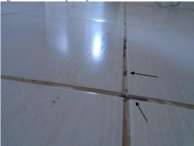
Figura 10: Deterioração da junta.
