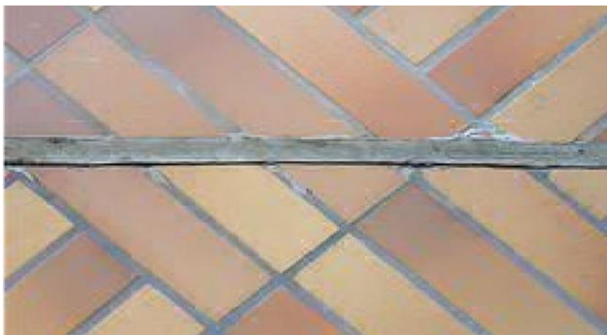
Figura 04: Deterioração de juntas.
