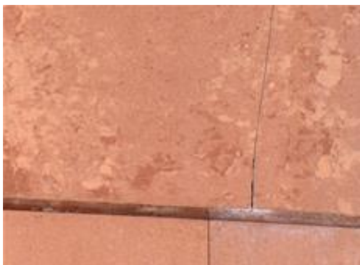
Figura 03: Trinca em piso cerâmico.
