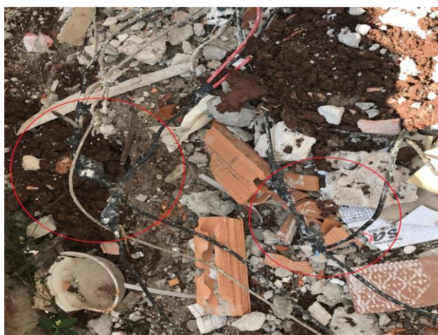
Figura 13 - Amostra B, isolamento inadequado. Fonte: Autor (2018).
