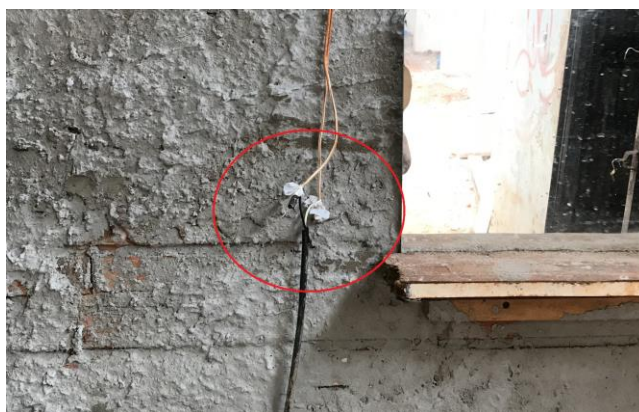
Figura 12 - Amostra A, isolamento inadequado. Fonte: Autor (2018).
