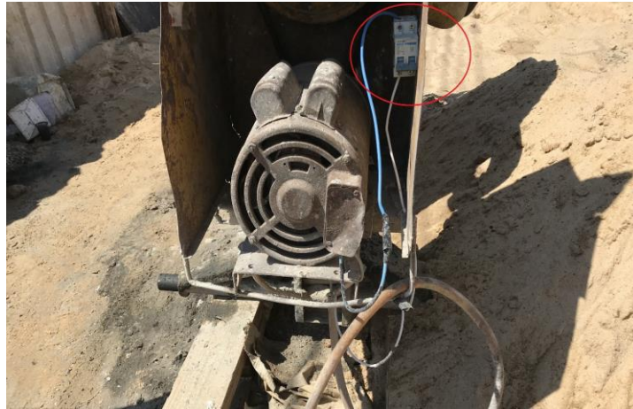
Figura 17 - Amostra B, acionamento por disjuntor eletromecânico.
