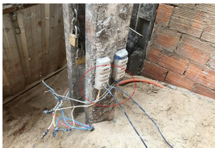
Figura 19 - Amostra B, condutor conectada diretamente em ponto tomada. Fonte: Autor (2018).
