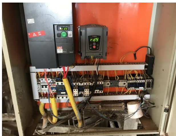
Figura 14 - Amostra A, quadro de distribuição da grua Fonte: Autor (2018).
