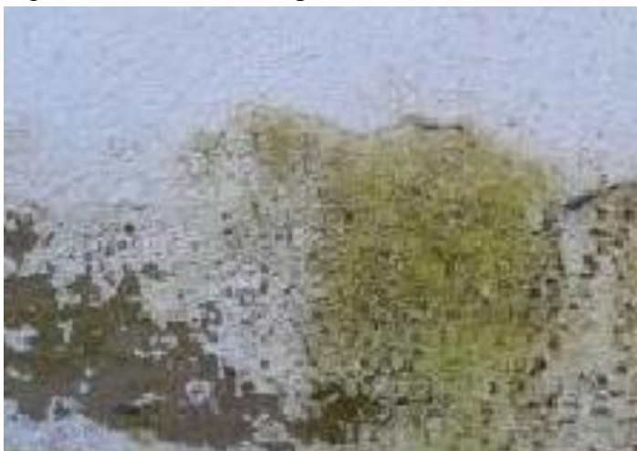
Figura 03 - Manchas em parede de alvenaria ocasionadas pela umidade
