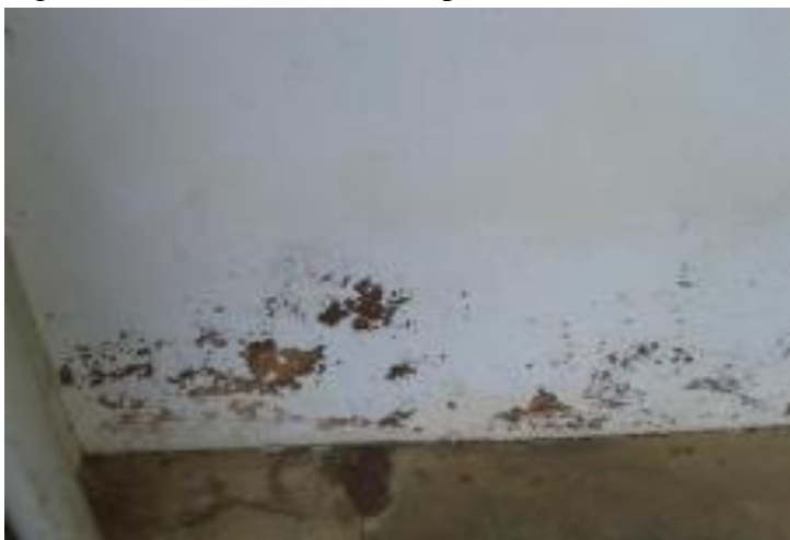
Figura 06 – Descascamento da pintura
