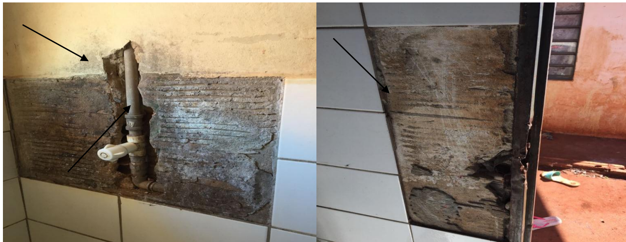
Figura 11 – Descolamento do revestimento cerâmico
