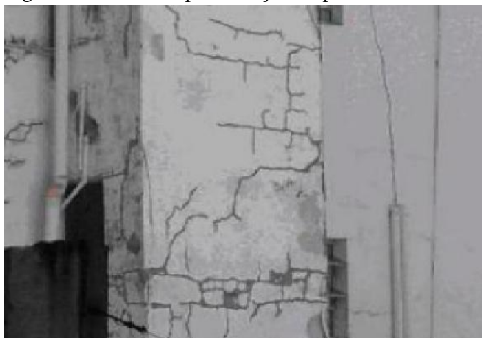
Figura 02 - Fissuras por retração de produtos cimentícios
