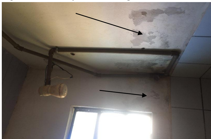
Figura 13– Presença de mofo na parede e teto
