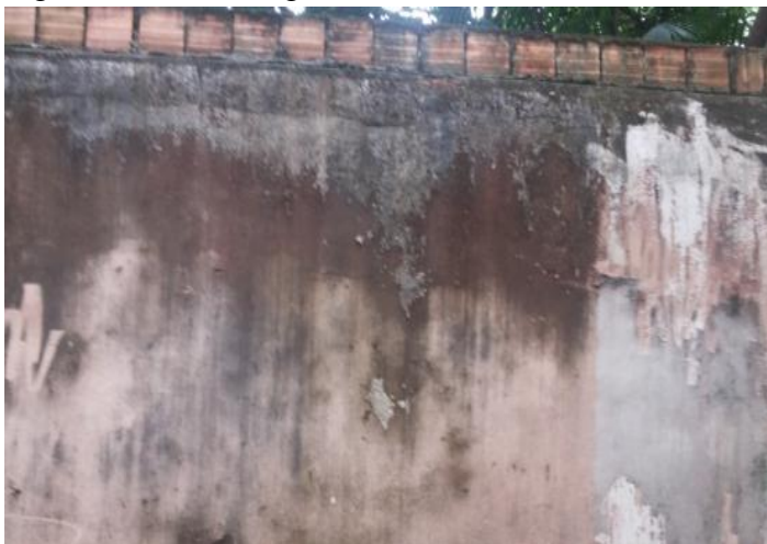
Figura 04 - Mofo ligado à existência de umidade
