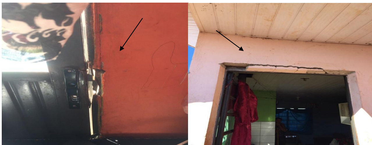
Figura 10– Descolamento de argamassa na ligação com a abertura metálica
