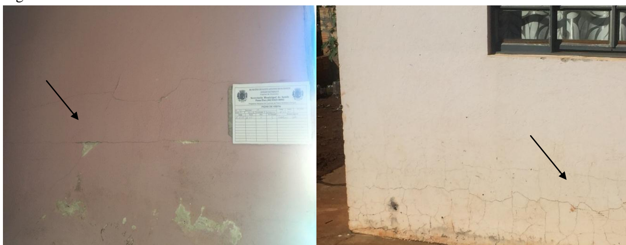
Figura 09 – Fissuras na área interna/externa
