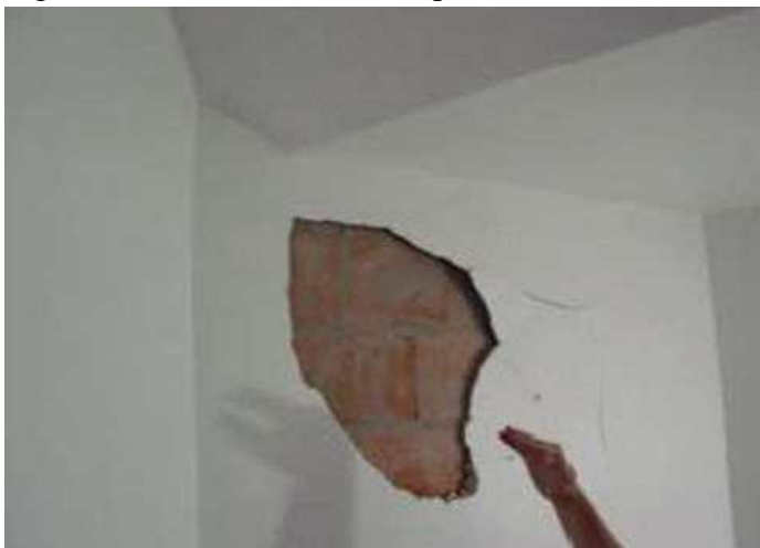
Figura 05 - Descolamento em parede de alvenaria
