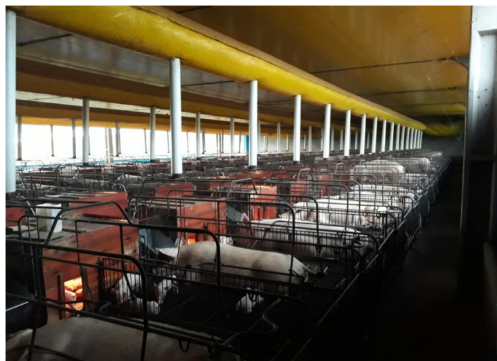
Figura 02 - Interior da maternidade das matrizes climatizada por tubulação.
