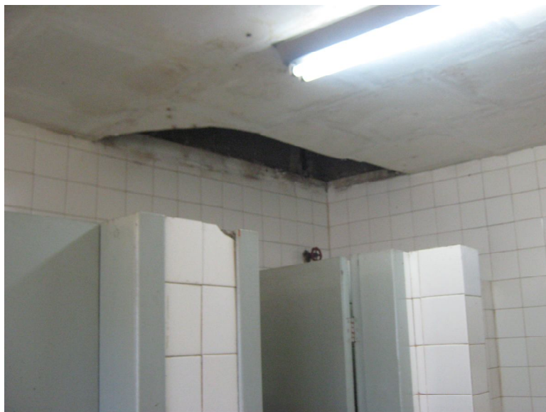
Figura 16: Abertura no concreto da Rodoviária de Francisco Beltrão Fonte: Dados coletados (2010)
